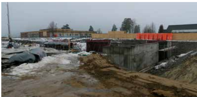
Bildet viser bygging av ny skole på Gvarv. Arbeidet starta før jul
